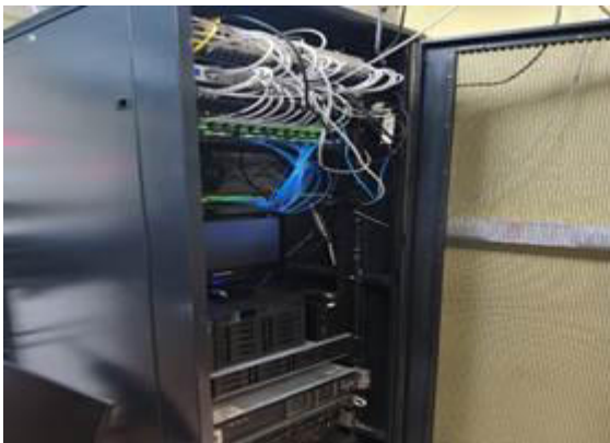
Rack de comunicaciones renovado
