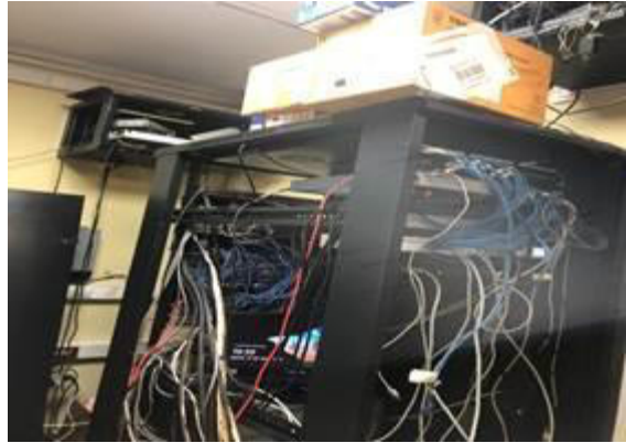
Rack de comunicaciones — Vista 2
