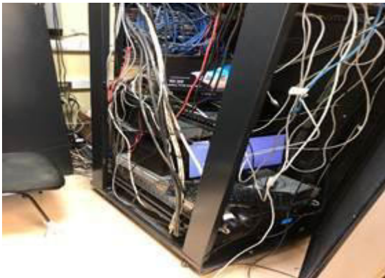
Rack de comunicaciones — Vista 3
